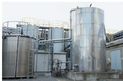
温水を保管するタンク
